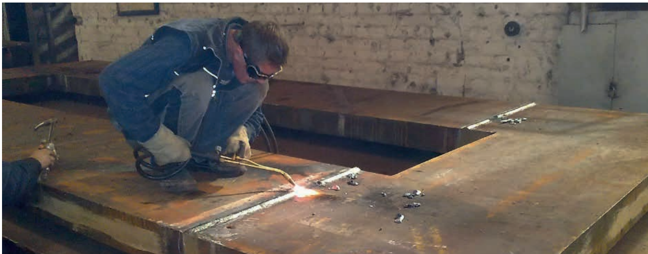
Рис. 16. Вырезка дефектов в корне сварного шва на металлоконструкции коробчатого сечения
