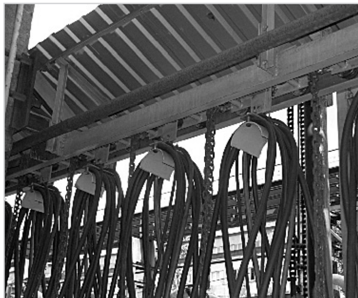
Рис. 7. Эстакада для транспортировки резиноканевых рукавов с энергоносителями от узлов подготовки кислорода и природного газа к МГР
