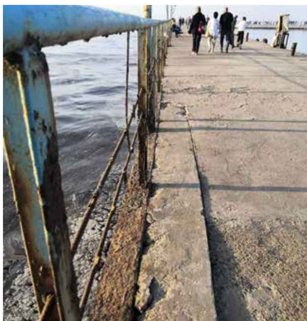
Рис. 3. Пирс причала городского яхт-клуба до ремонта
