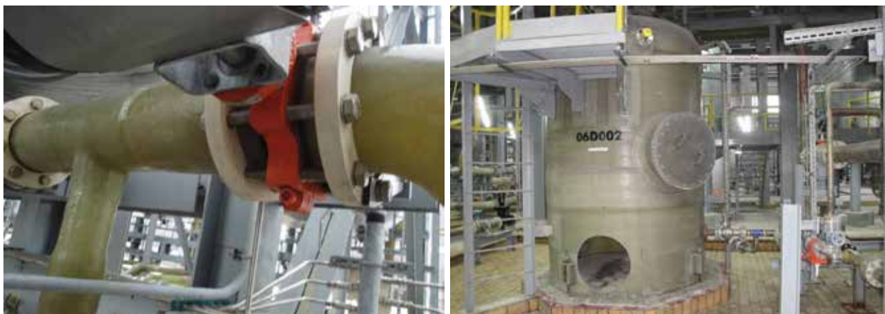
Рис. 4. Трубопроводы и емкости
